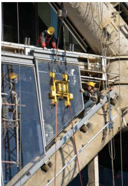
图13.工人们正在安装构成保利国际广场双层幕墙的玻璃。如此复杂几何形间的协调只有借助BIM系统的发展才能实现。
