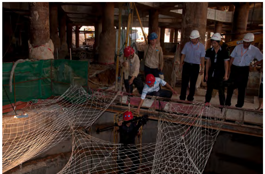
Figure 2.16. Construction of the deep basement (Source: Ping An) 图 2.16 深地下室施工 (来源: 平安)
